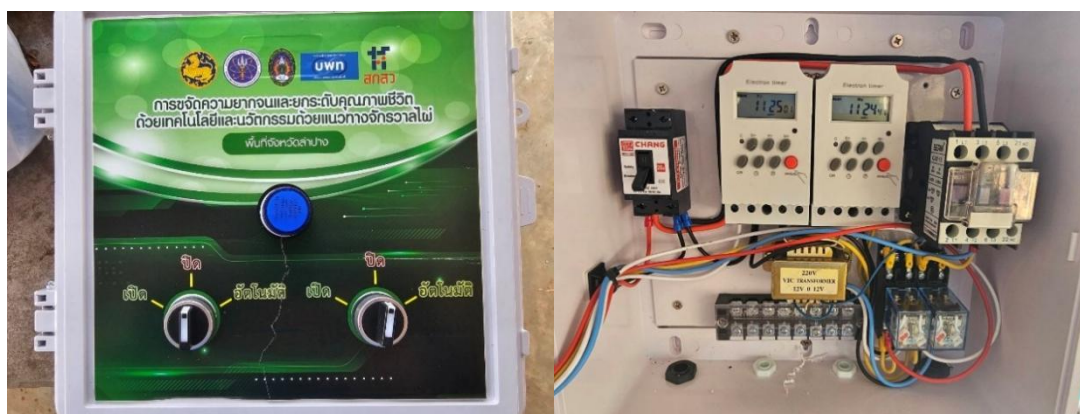
ภาพที่ 4.7 การติดตั้งระบบสมาร์ทฟาร์มสำหรับสวนไผ่
